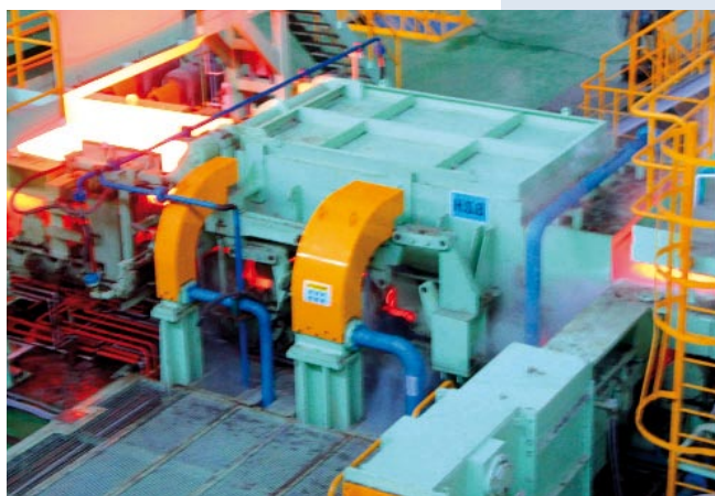
Figura 6. Descarepador na entrada da linha de acabamento na laminadora de tiras a quente da Hyundai Steel
